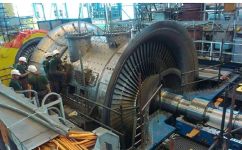
Jaderná elektrárna Temelín Odkrytý nízkotlaký díl turbíny.
